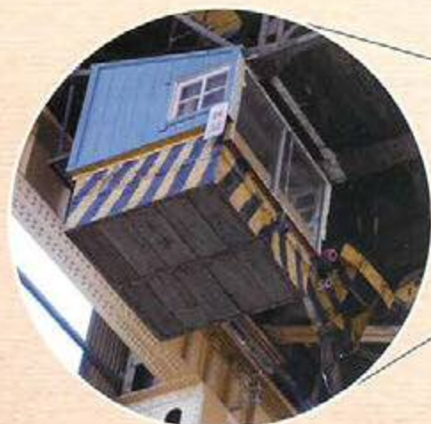
50トンの天井クレーン、ボックスは運転室
