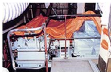
新設された高圧注水ポンプ(非常用炉 心冷却設備の一部)
