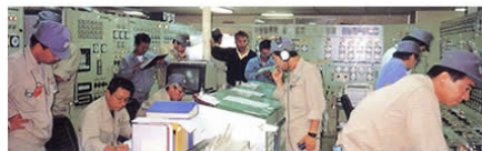
実験航行中の制御室内
