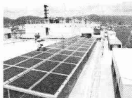
【②甲板上の太陽電池】
