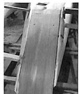
写真 28 ミオシ部のタナの割れ
