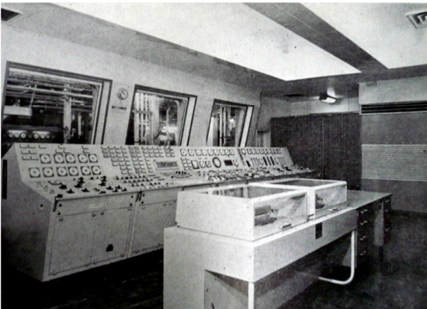
11) W45-11 沖の嶋丸 機関制御室
