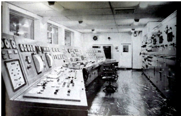
24) W46-24 光珠丸 機関制御室
