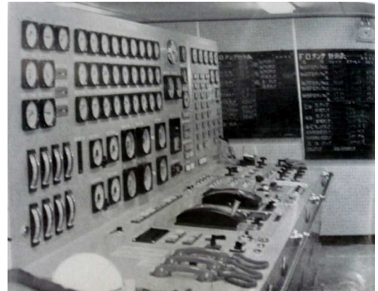
2) W55-02 おおすみ 機関制御室
