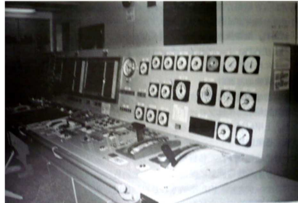
27) W58 - 27 ZARAGOZA 機関制御室
