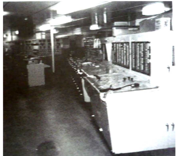
9) W58-09 クリーン りばー 機関制御室
