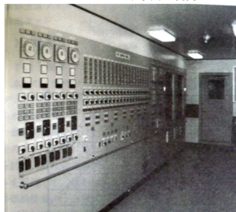
12) W59-12 ベティ ビー 冷凍装置制御盤
