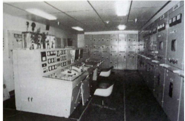
16) W60-16 ほうらい丸 機関制御室
