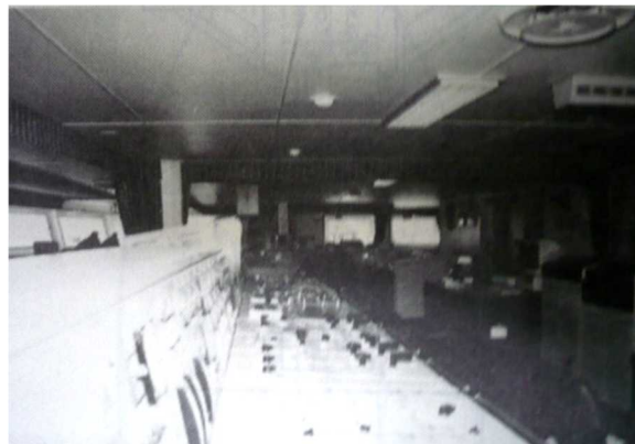
8) W63-08 日石丸 集中監視制御室
